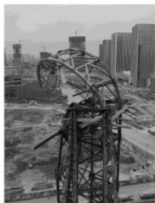
图1 塔吊大臂严重变形
